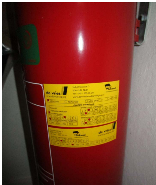
Foto: brandblusser met keuringslabel
