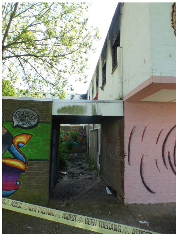
Foto: vrijkomen asbest na brand
